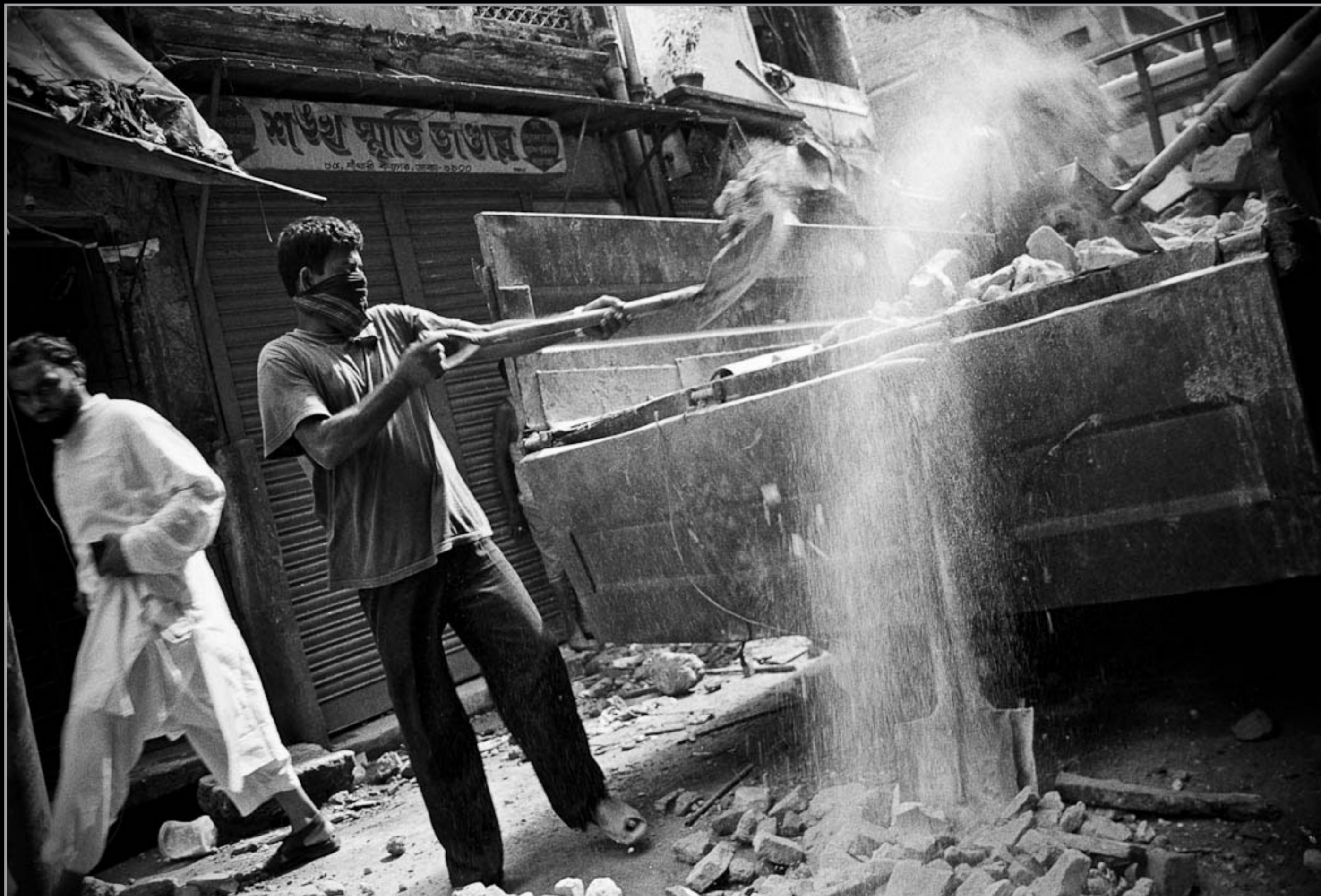
Arbeiter räumen die Überreste des am Vortag eingestürzten Gebäudes in der Altstadt von Dhaka auf.
